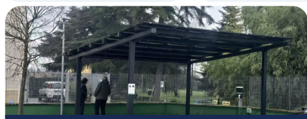
Vela installato in Italia (foto GoodWe)
