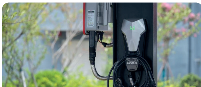
Ricarica sotto il carport: wallbox e inverter GoodWe montati sul pilastro (foto GoodWe)
